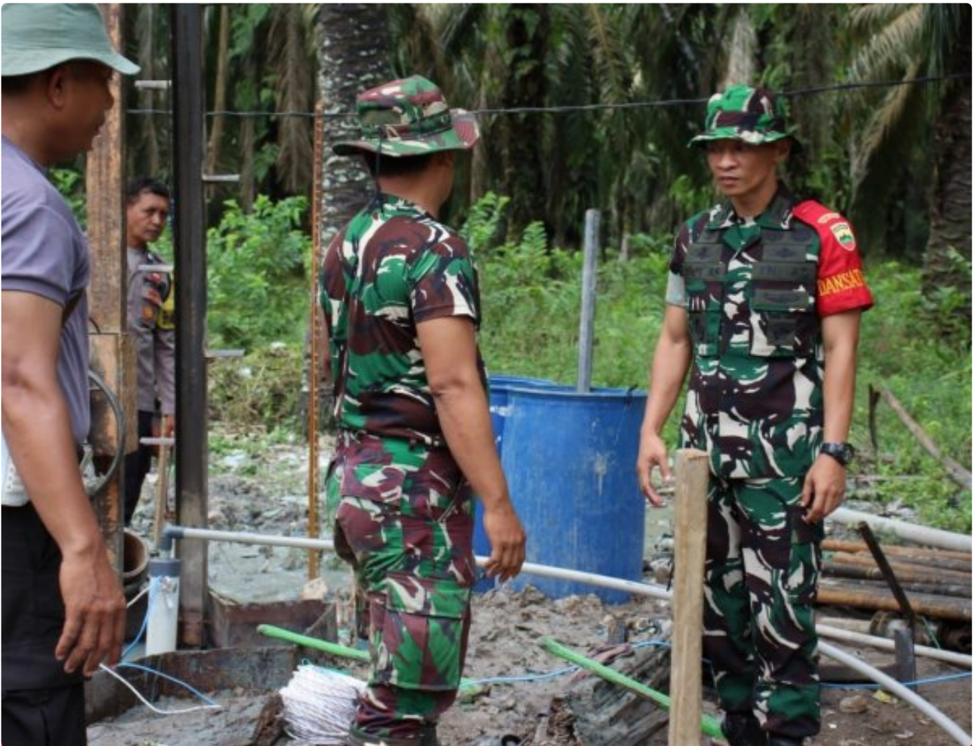
Dansatgas TMMMD ke 120 Kodim 0209/LB Monitoring Pembuatan Sumur Bor di Dusun 2 Desa Selat Beting
